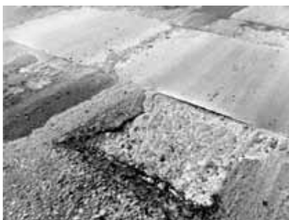
Рис. 13. Недопустимые выбоины дорожного покрытия глубиной около 100 мм на подъезде к весам «В2»
